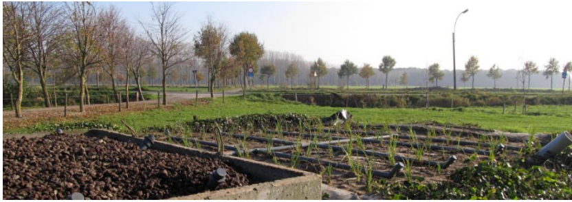
Figuur 16. AgrAqua - Voorbeeld aanleg van een zuiveringssysteem voor afvalwater (bedrijfswoning, melkwinning en run-off van de kuilplaat)
