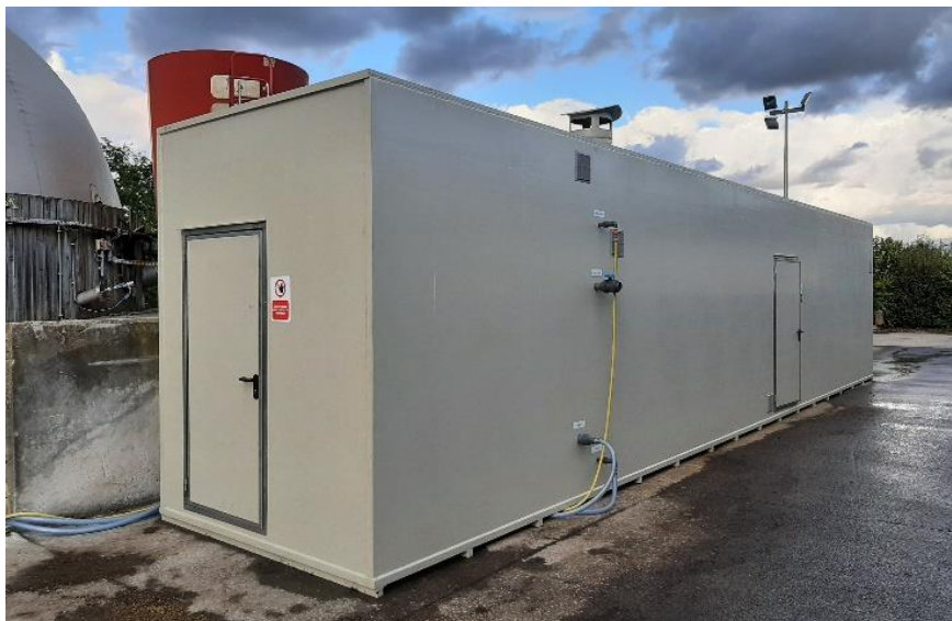
Figuur 1. Stripping-scrubbing installatie.
