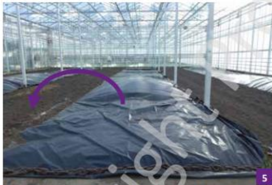
De tweede dag worden de kettingen aan de rechterkant losgemaakt en wordt het zeil naar de linkerkant van de beuk gebracht.
